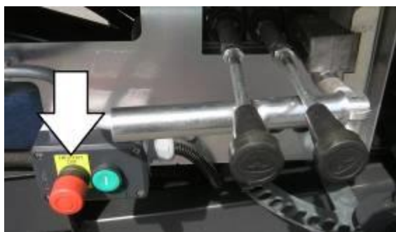
Afb. 14 a: NOODSTOP schakelaar (pijl) aan de bedieningsconsole.
