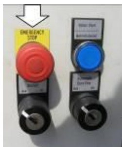
Afb. 15 a: NOODSTOP schakelaar (pijl) op de schakelkast
